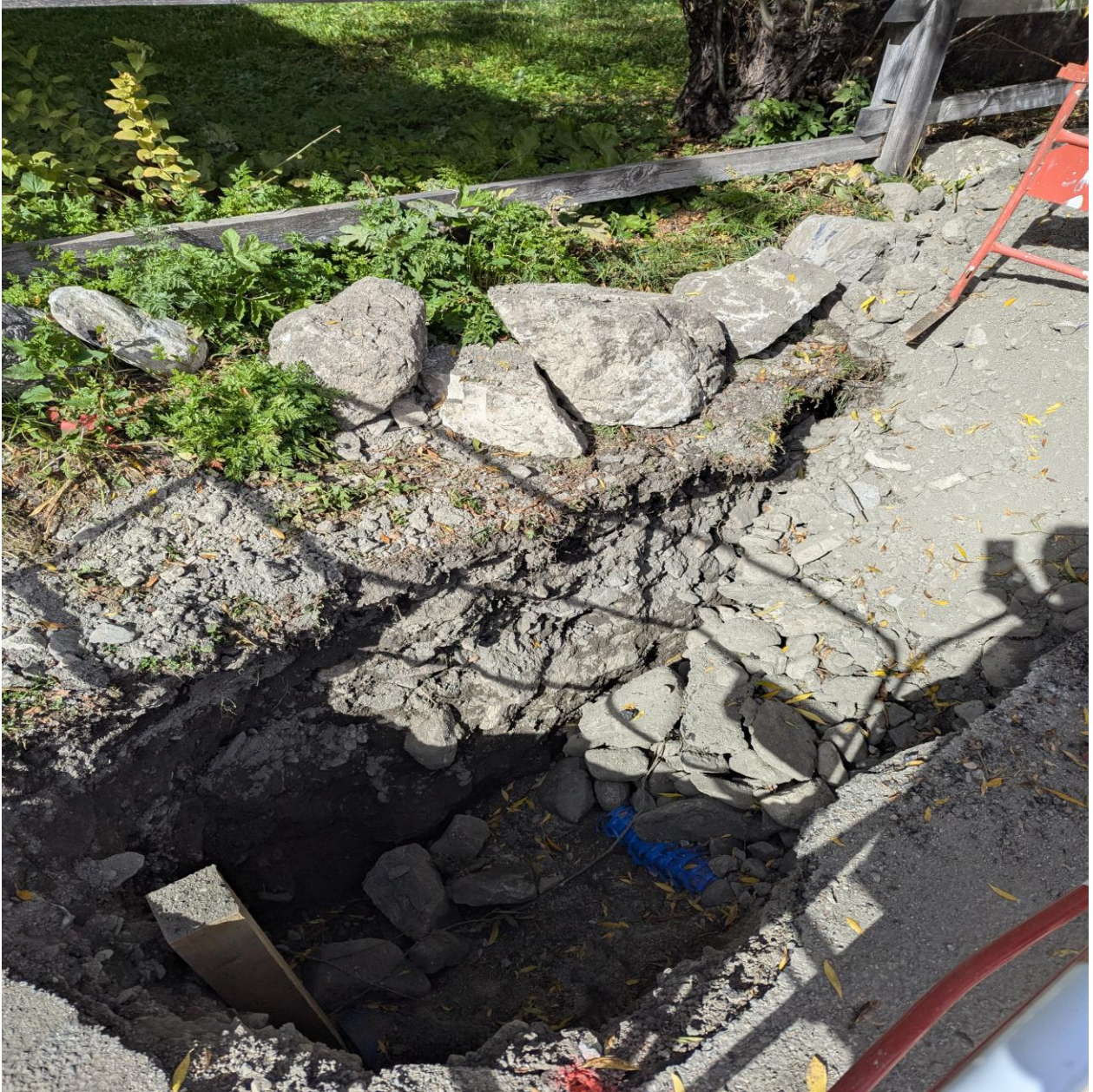
Figure 1 : Conduite en attente au niveau de la Belière provenant du parking
