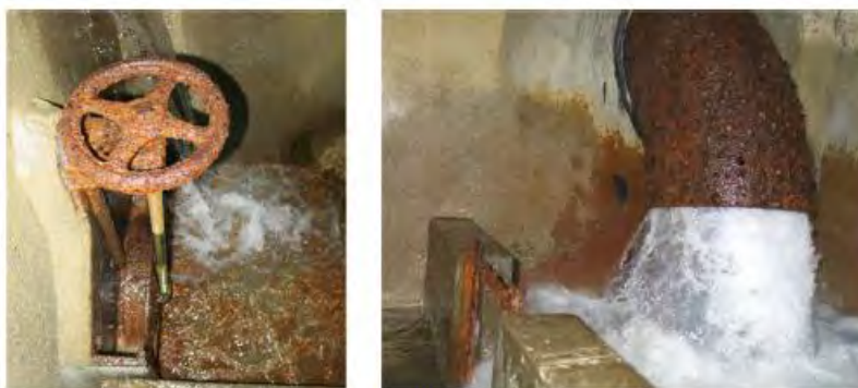
Détail des équipements - corrosion avancée
