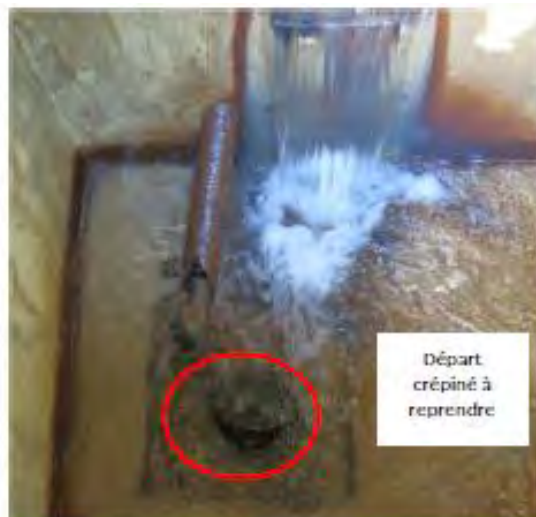
Détail du bac de mise en charge
